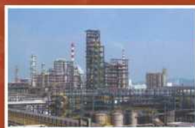
化工用管 Cracking pipe
